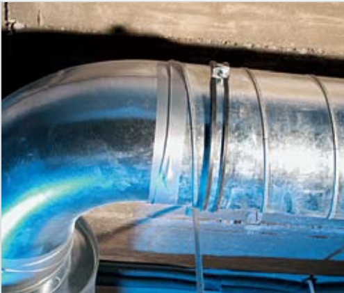
Befæstigelse for ventilationsanlæg
