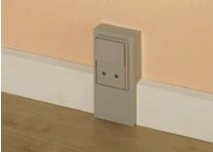
34. Eksisterende stikkontakt i fodliste.
