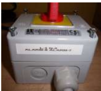
Afbryderkontakt i renselanlæggets teknikkasse, hvor strømforsyning tilsluttes
