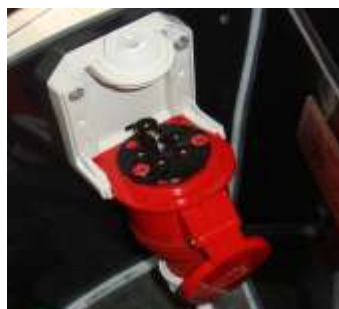
CEE-stik i renselanlæggets teknikkasse, hvor strømforsyning tilsluttes (alternativ til afbryderkontakt).
