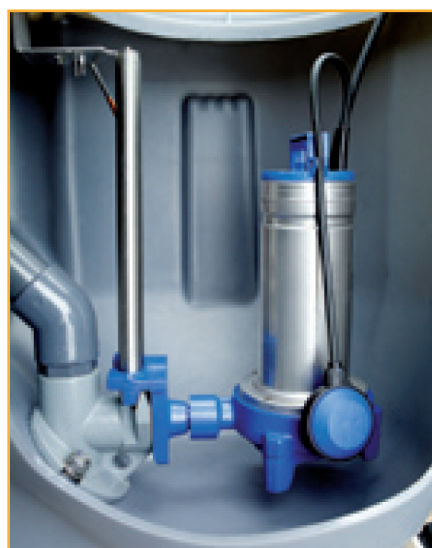
Dykket installation med koblingsfod og guiderør. Her i en Flygt Micro 7 station.
